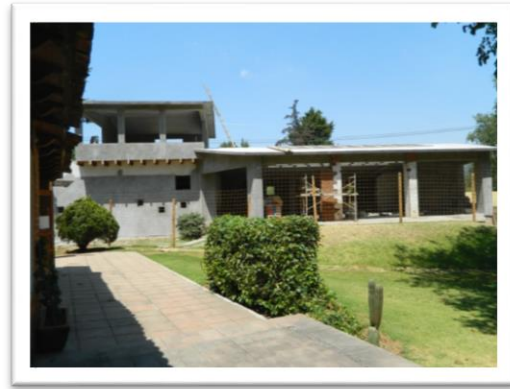
Ilustración 3 Edificación ya existente para remodelación y acondicionamiento del spa ( izquierda : vista desde el exterior del condominio residencial; derecha : vista desde el interior)
