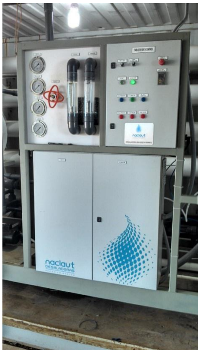
Foto 4. Panel de control e indicadores de funcionamiento del módulo de desalinización.
