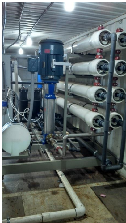
Foto 5. Interior de uno de los módulos de desalinización.
