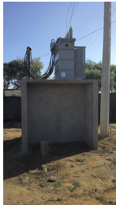
Foto 6. Subestación eléctrica de 500 KVA, que alimenta la planta desalinizadora.
