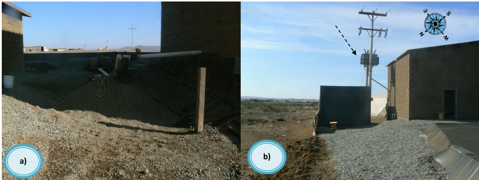
Foto 6. a) Vista del pozo que suministra agua salobre a la planta desaladora y b) subestación eléctrica de la planta desaladora.
