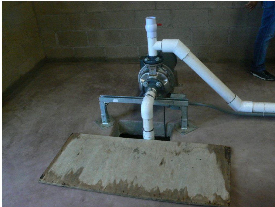
Foto 4. Bomba de succión en la pila del agua del pozo agrícola que alimenta la planta desaladora.
