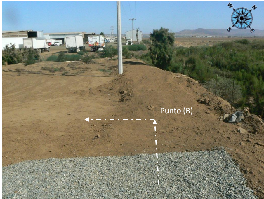
Foto 10. Conducción de la Sección I de la tubería dentro del predio del proyecto punto (B).
