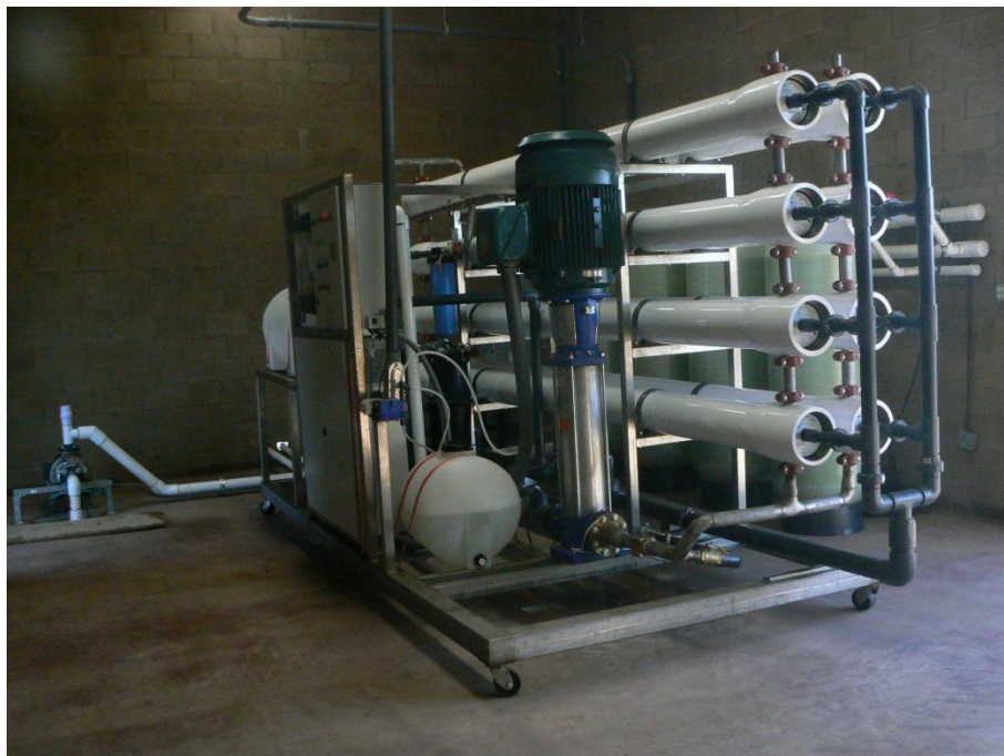
Foto 2. Vista del módulo de osmosis inversa dentro de la nave, al fondo se puede apreciar el sistema de filtros multimedia.
