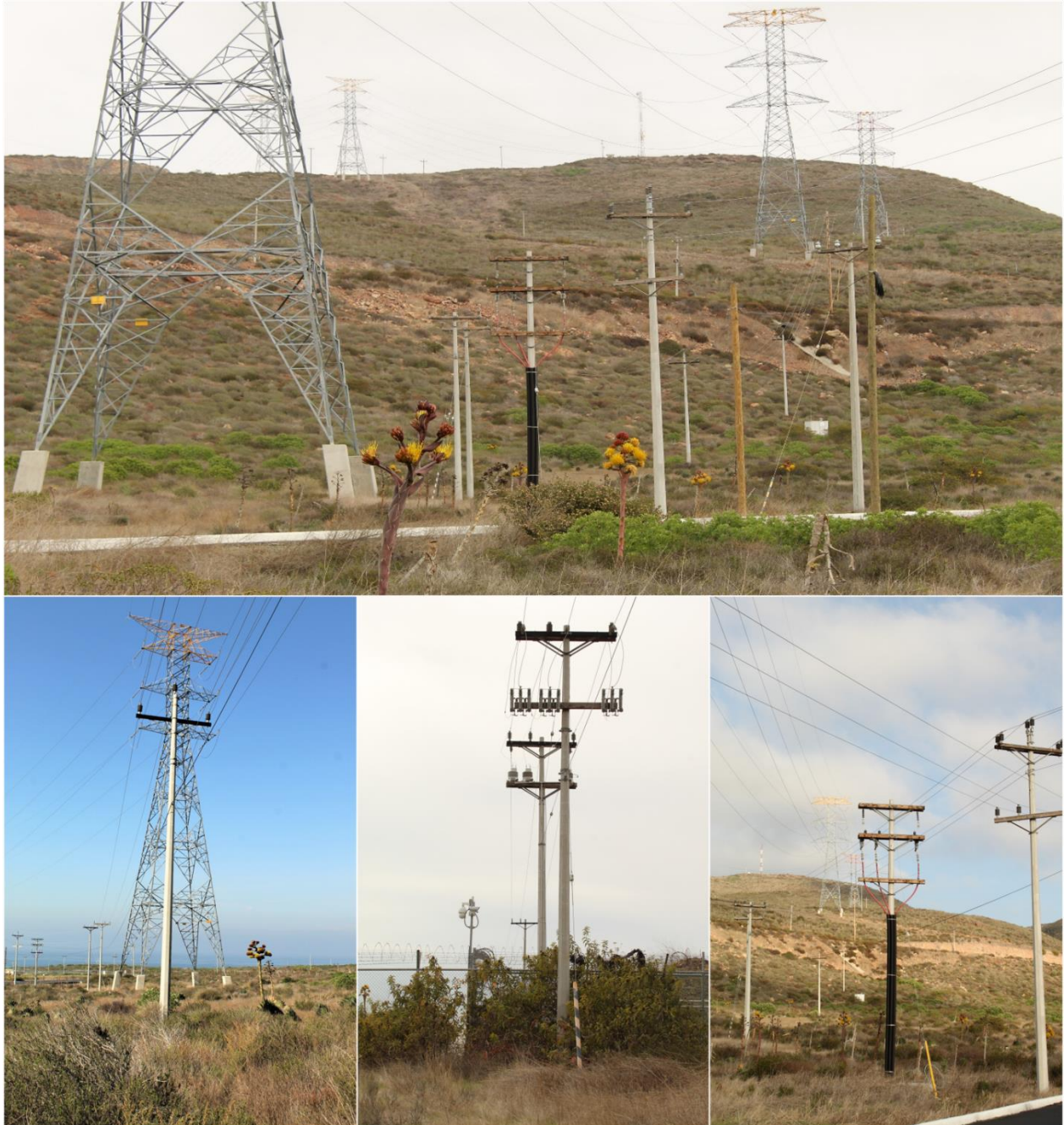
Imagen II.52. En el SAR y AI se observan torres y postes como parte de las líneas de interconexión, transmisión y distribución eléctrica existente que forman parte de CFE La Jovita y ECA.
