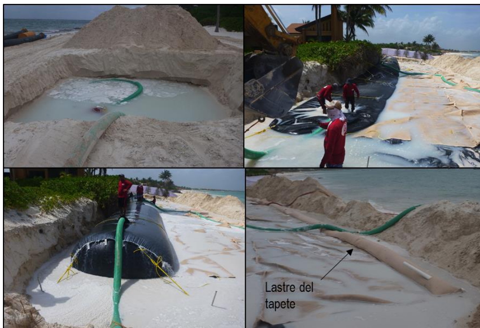
Imagen II.41. Ejemplo del proceso de llenado de los geotubos. Arriba izquierda) tarquina para mezcla de agua y arena; arriba derecha) extendido de geotubo y tapete; abajo izquierda) proceso de hidrollenado usando el puerto de llenado y abajo derecha) llenado de tubo de anclaje del tapete antisocavación.
