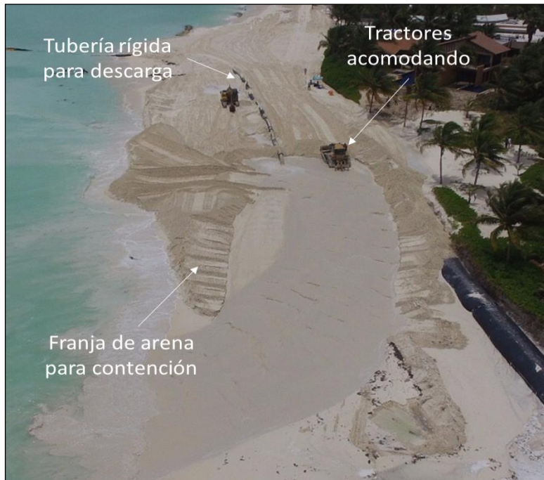
Imagen II.47. Ejemplo de la descarga de mezcla agua-arena en la playa con tubería rígida y maquinaria de apoyo para acomodar la arena vertida.
