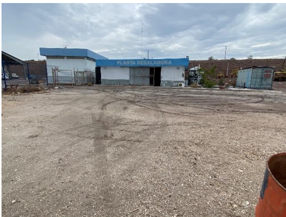
Planta desaladora de ósmosis inversa
