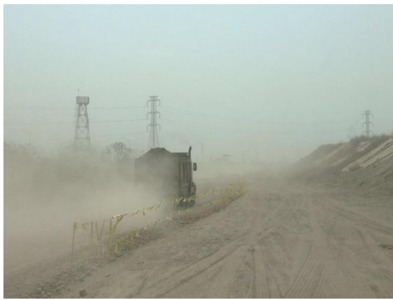
Suspensión de partículas de polvo en un camino de terracería por donde se transporta material de construcción.
