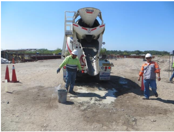
Contaminación de suelo por disposición incorrecta de residuos de mezcla y lavado de ollas.
