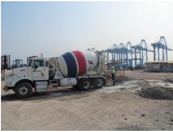
Contaminación de suelo por derrame de concreto durante el colado.
