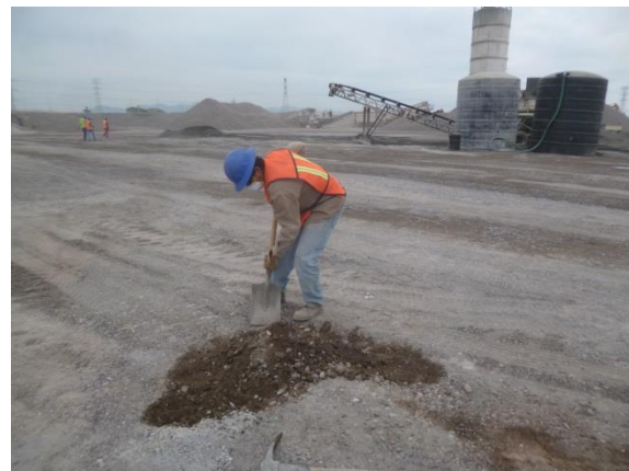
Recolección de suelo contaminado por derrame de hidrocarburos para disposición en el almacén temporal de residuos peligrosos
