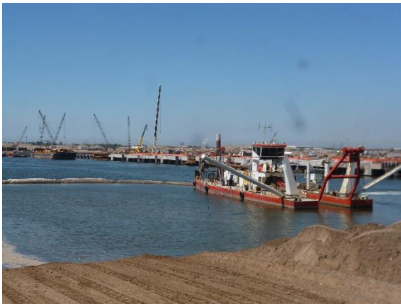
Draga de succión con línea de conducción para material dragado
