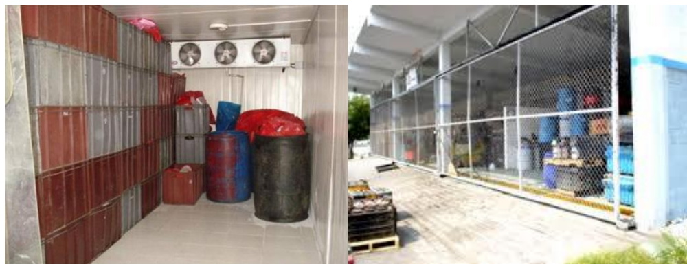
Fotos II.8. Las imágenes muestran ejemplos del almacenamiento provisional adecuado de los residuos generados en obra.
