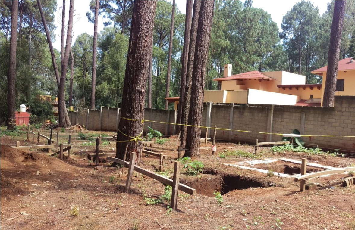
Foto 5.- Excavaciones para las cimentaciones del proyecto. En la imagen se puede observar que el predio colinda con casas habitación.
