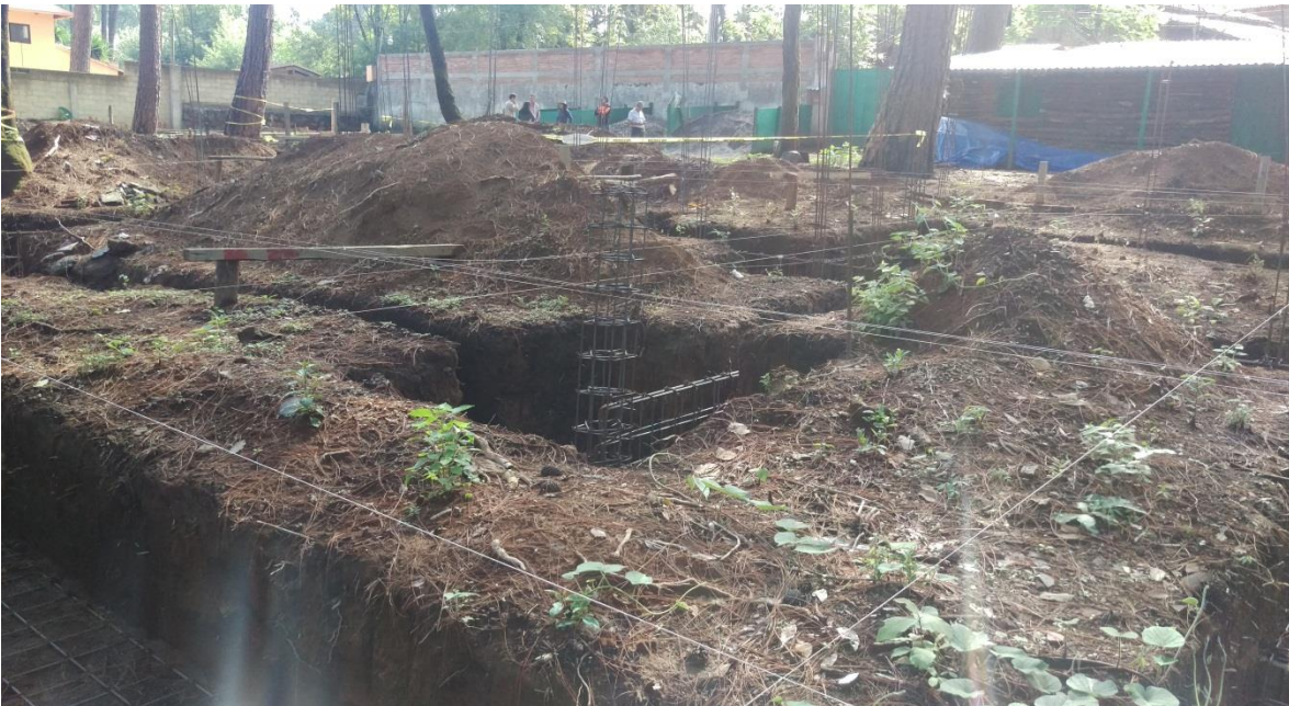
6.- En la imagen se puede observar las cimentaciones con el armado de las cadenas con varilla y alambre.
