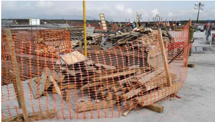
Figura VI. 1. Ejemplo de área delimitada para el almacenamiento temporal de residuos de manejo especial. Tomada de internet como referencia.
