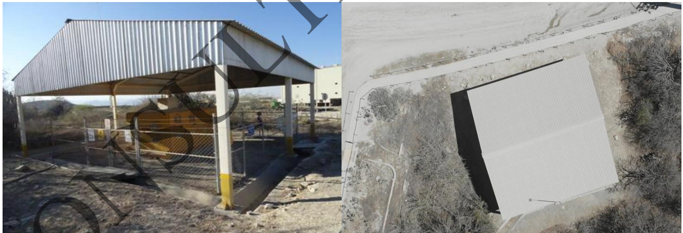
Figura 2.81. Vista general de la subestación eléctrica que alimenta a mina y vista aérea tomada con Dron en marzo de 2019
