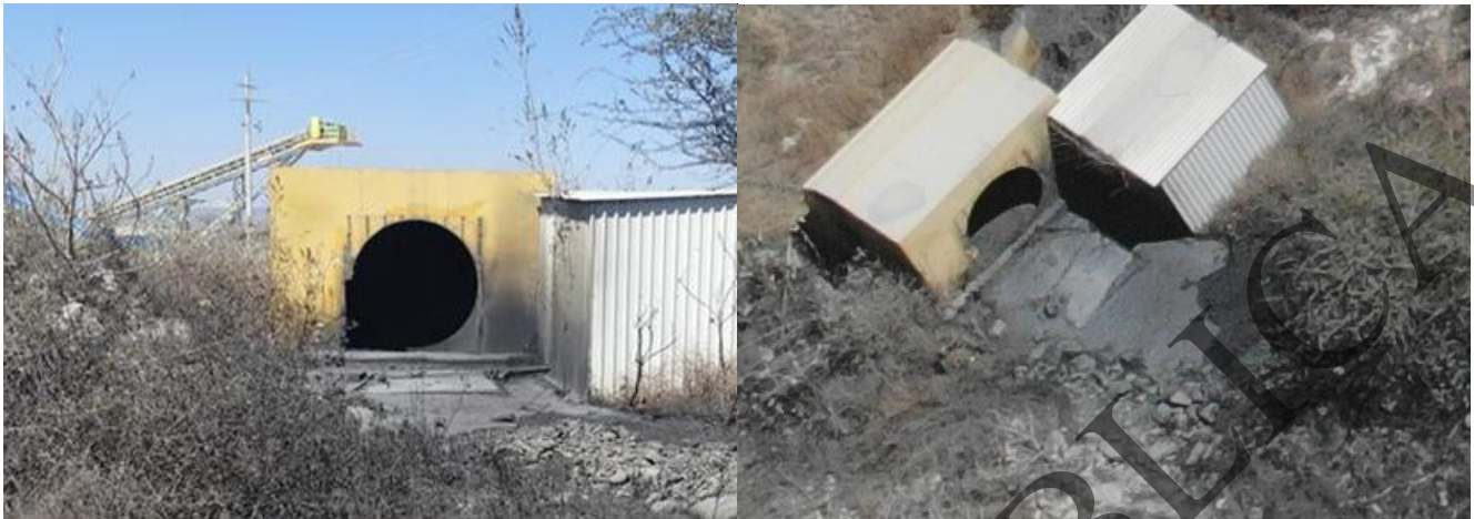
Figura 2.46. Vista general del Contrapozo de ventilación y vista aérea tomada con Dron en marzo de 2019
