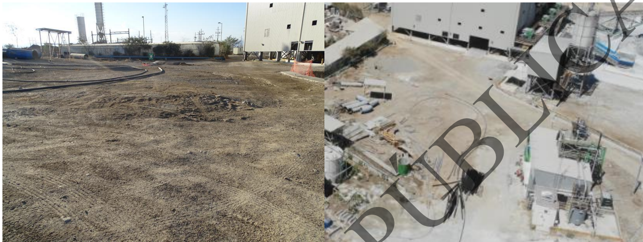
Figura 2.52. Vista general del área de Selección de jales y vista aérea tomada con Dron en marzo de 2019
