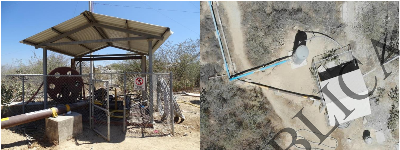
Figura 2.42. Vista general del Cuarto de rebompeo y vista aérea tomada con Dron en marzo de 2019
