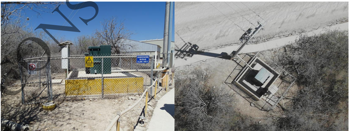
Figura 2.43. Vista general del Transformador y vista aérea tomada con Dron en marzo de 2019
