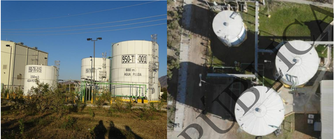
Figura 2.73. Vista general de los Tanque de almacenamiento de agua y vista aérea tomada con Dron en marzo de 2019
