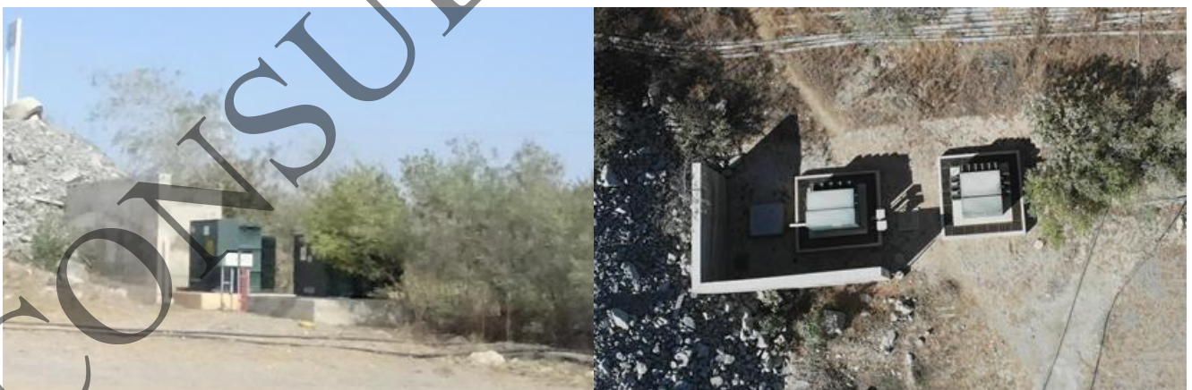
Figura 2.20. Vista general de los dos transformadores eléctricos y vista aérea tomada con Dron en marzo de 2019
