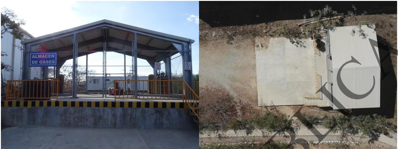
Figura 2.29. Vista general del almacén de gases y vista aérea tomada con Dron en marzo de 2019
