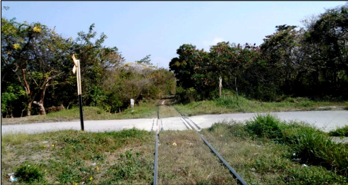
Figura No.20. Cruce de ferrocarril con señalamiento y los rieles sumidos.
