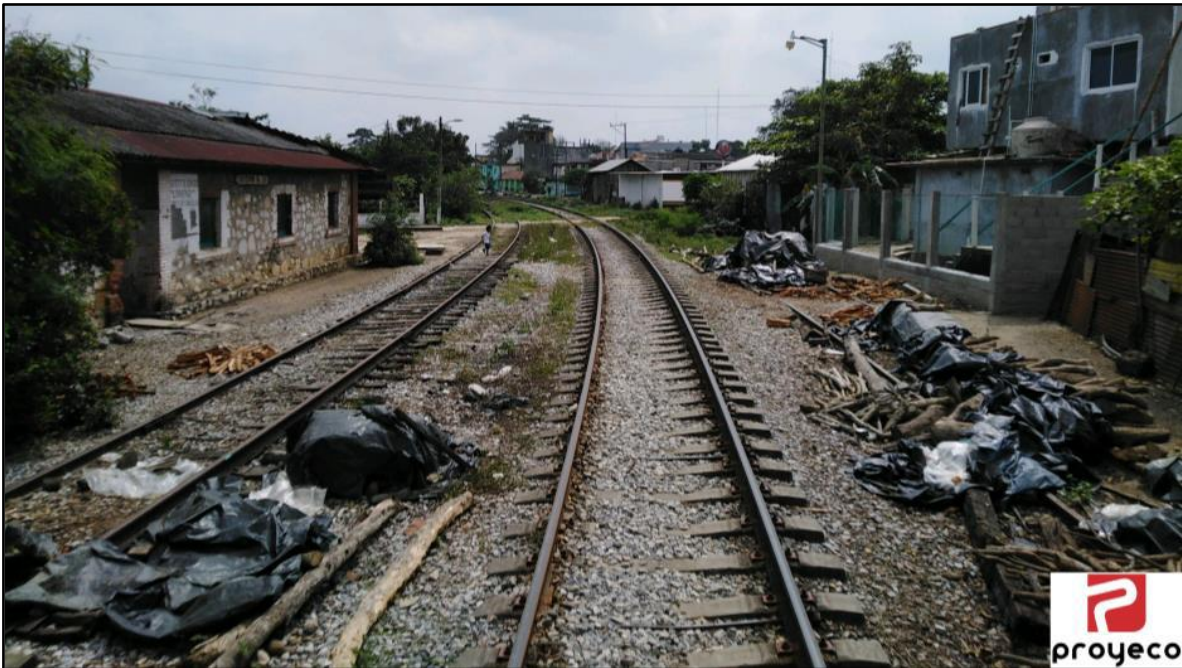
Figura No.15 Basuras en área del riel.
