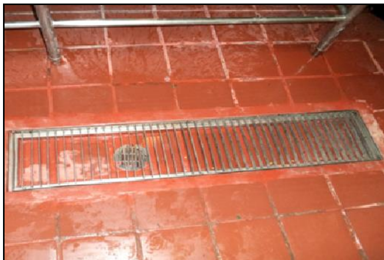
Detalle de una de las rejillas de las cocinas para captar las aguas grasas y jabonosas.
