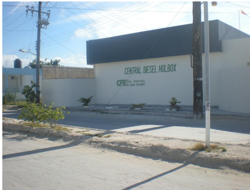
Fig. 22.- Planta generadora de energía eléctrica CFE Isla Holbox.
