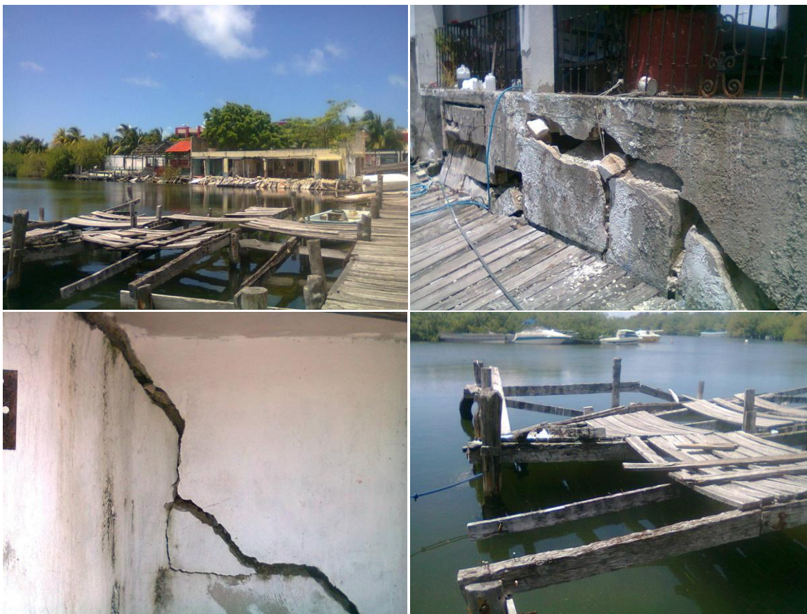
Figura II.3 Fotografías de las infraestructuras después del Huracán Wilma.
