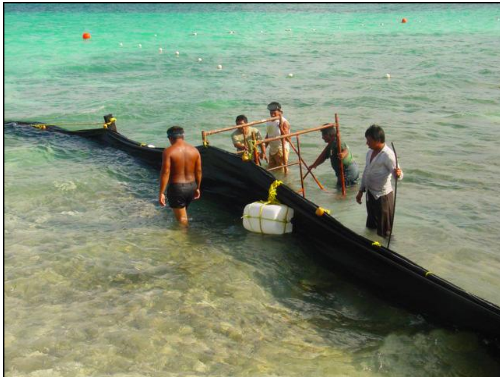
Ejemplo de la colocación de una malla geotextil, misma que deberá ser ubicada entre la zona de los trabajos de construcción y las áreas circunvecinas, a fin de evitar la dispersión de plumas de sedimentos bentónicos que pudieran ser arrastrados y afectar comunidades de organismos en otras zonas.
