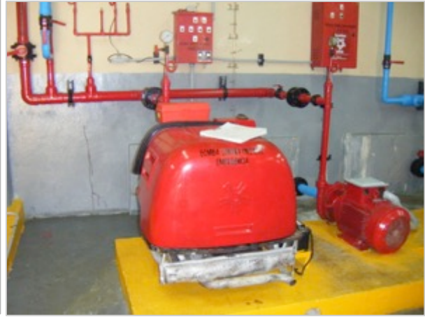
Bomba contra Incendios
