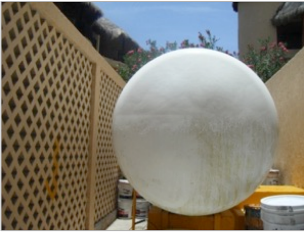
Tanque de gas LP
