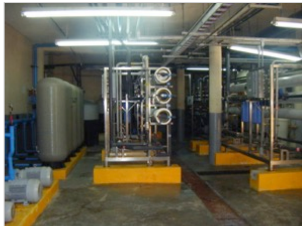
Planta de Osmosis Inversa
