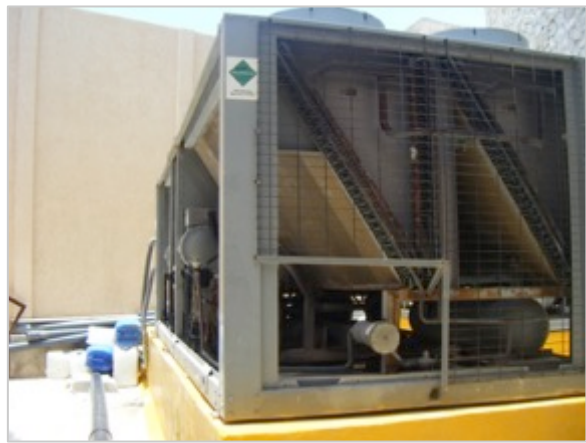
Schiller del aire acondicionado
