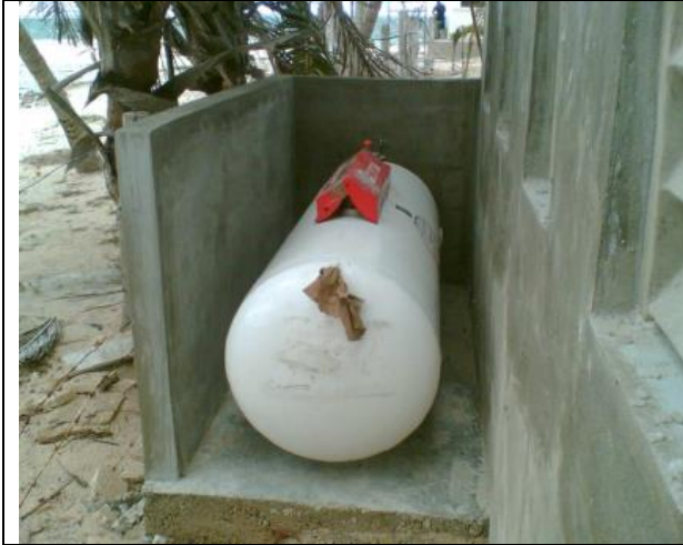
Ejemplo de tanque estacionario de Gas.
