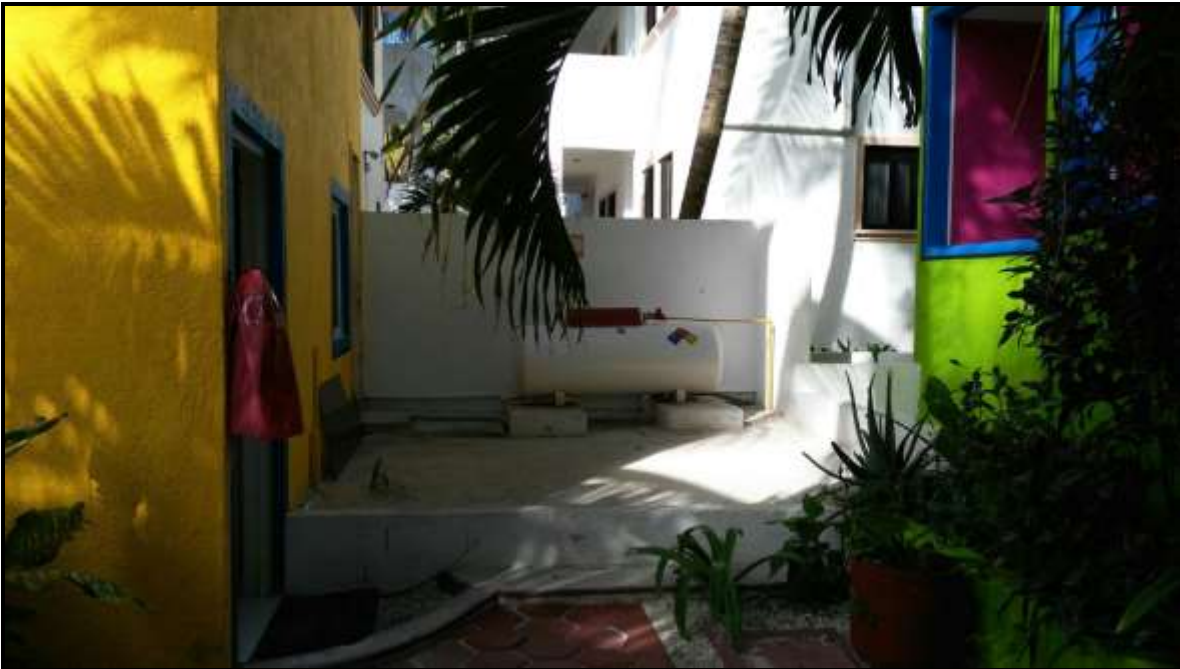
Figura II. 8. Área en donde se ubica un tanque estacionario
