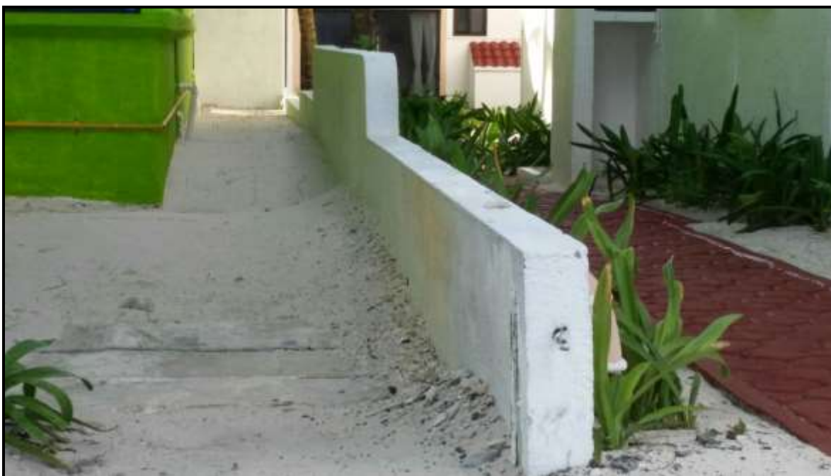
Figura II. 9. Área con suelo arenoso a manera de pasillo y barda sur del predio.
