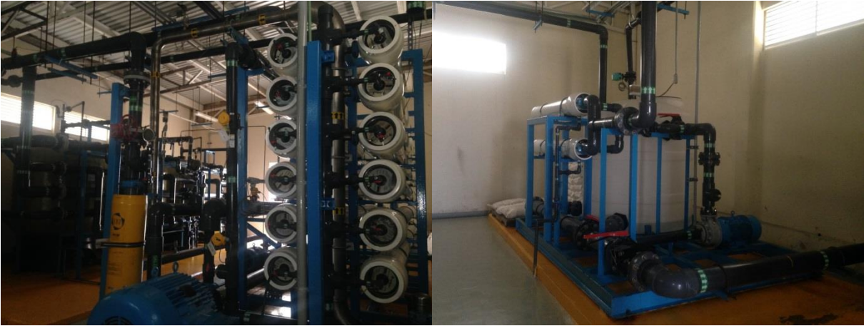
Figura 2.21. Imágenes del interior de la planta de ósmosis inversa del Proyecto.
