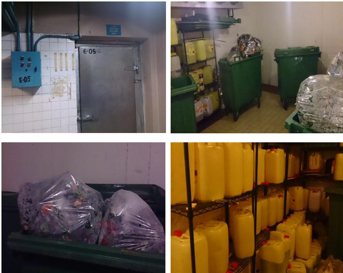
Figura 2.53. Imágenes de la cámara de basura húmeda del Proyecto.
