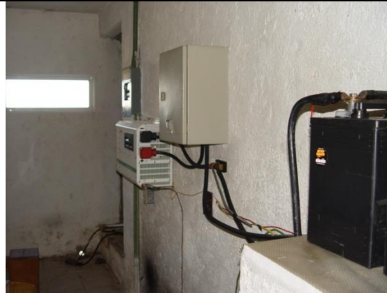
Convertidor de energía que la canaliza a las baterías.
