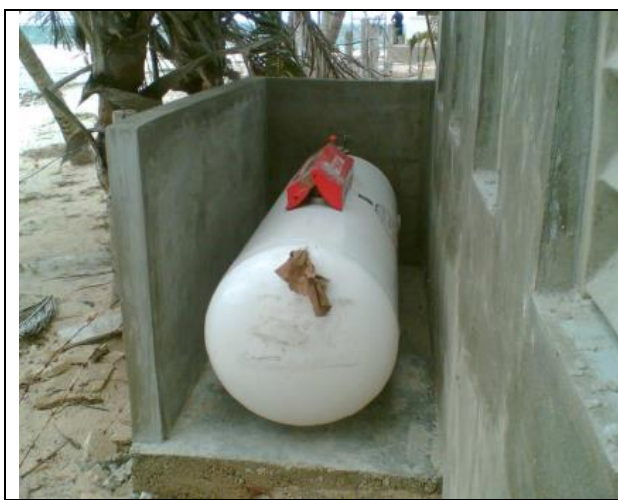
Ejemplo de tanque estacionario de Gas.
