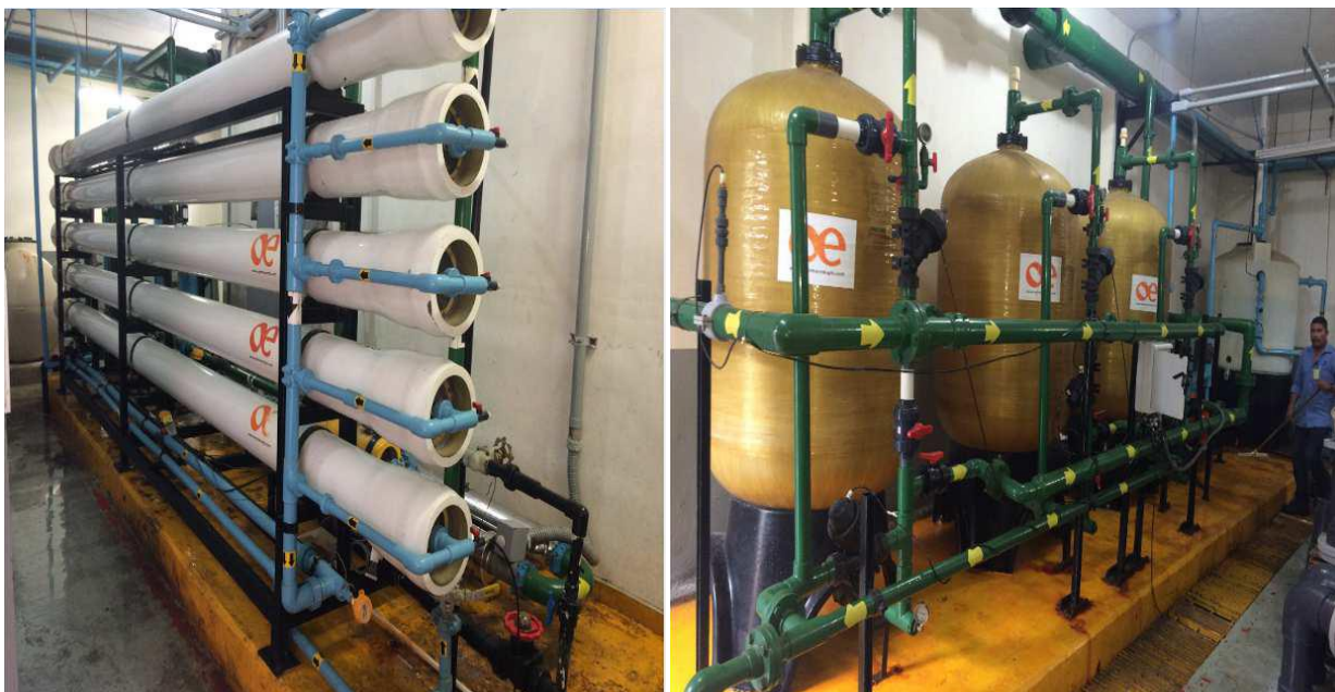
Equipos de Osmosis Inversa que se utiliza para desalar el agua desde concentraciones de 136,000 ppm hasta una concentración de aproximadamente 300 ppm, produciendo un volumen de 55.55 Gal/min de agua permeada.
