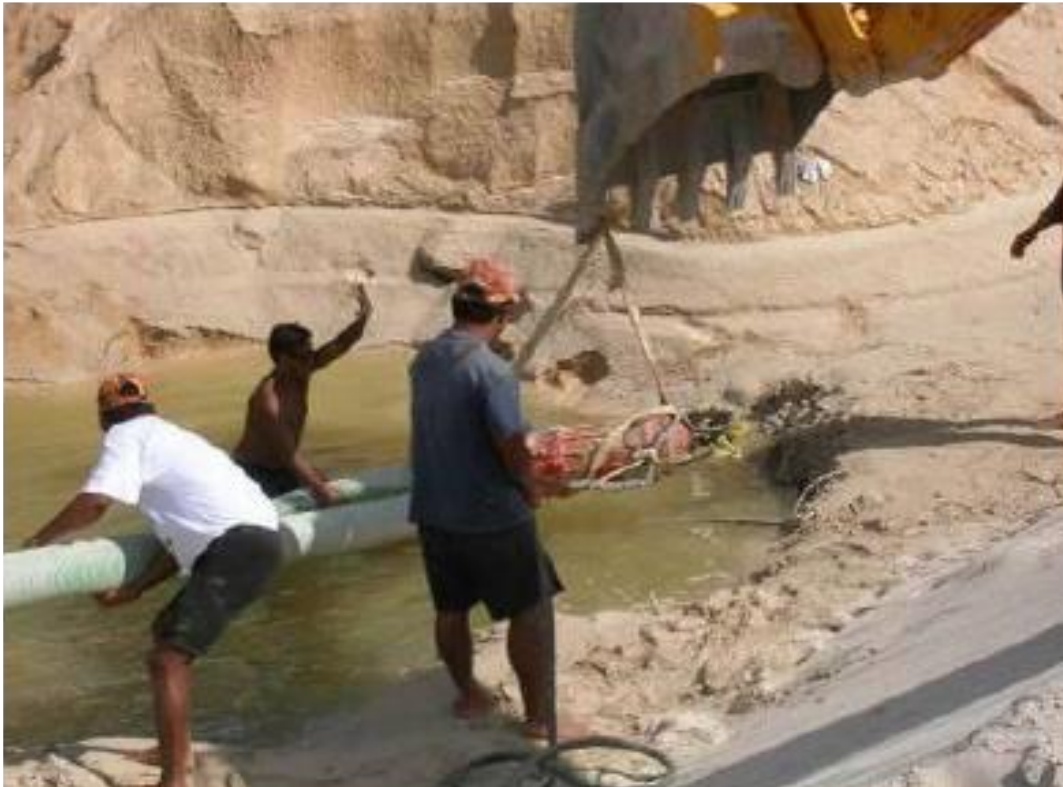
Figura 2. 13. Introducción de la bomba con las mangueras de succión y bombeo conectadas.
