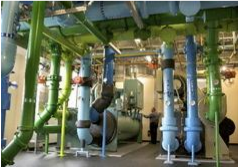
Imagen II-18. Sistema de distribución de aire acondicionado.
