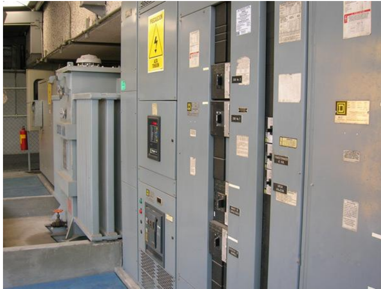
Imagen II-17. Cuarto de control eléctrico.
