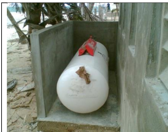
Ejemplo de tanque estacionario de Gas.
