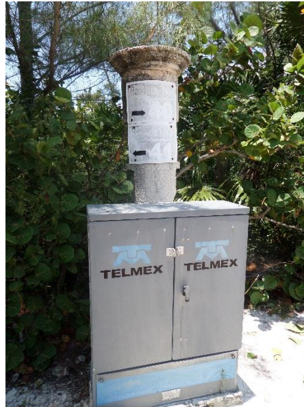
Figura 15. Se muestra el registro de TELMEX.
