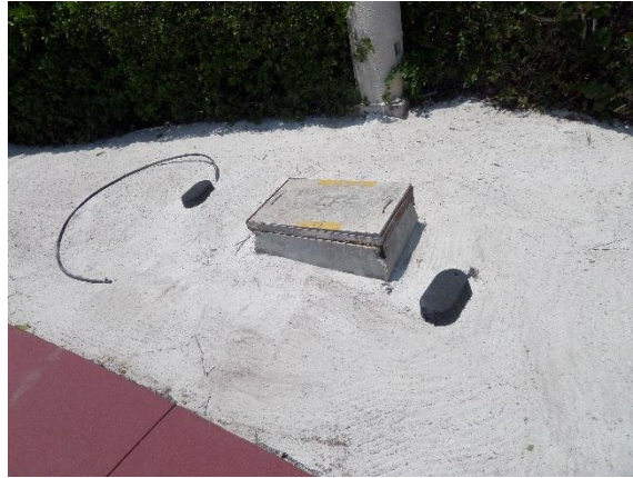
Figura 14. Se muestran a los lados del registro de energía eléctrica las tomas de agua.
