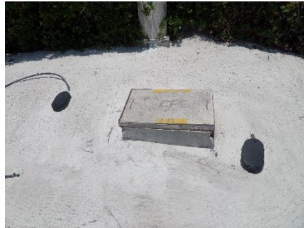
Figura 13. Se muestra el registro de la CFE.
