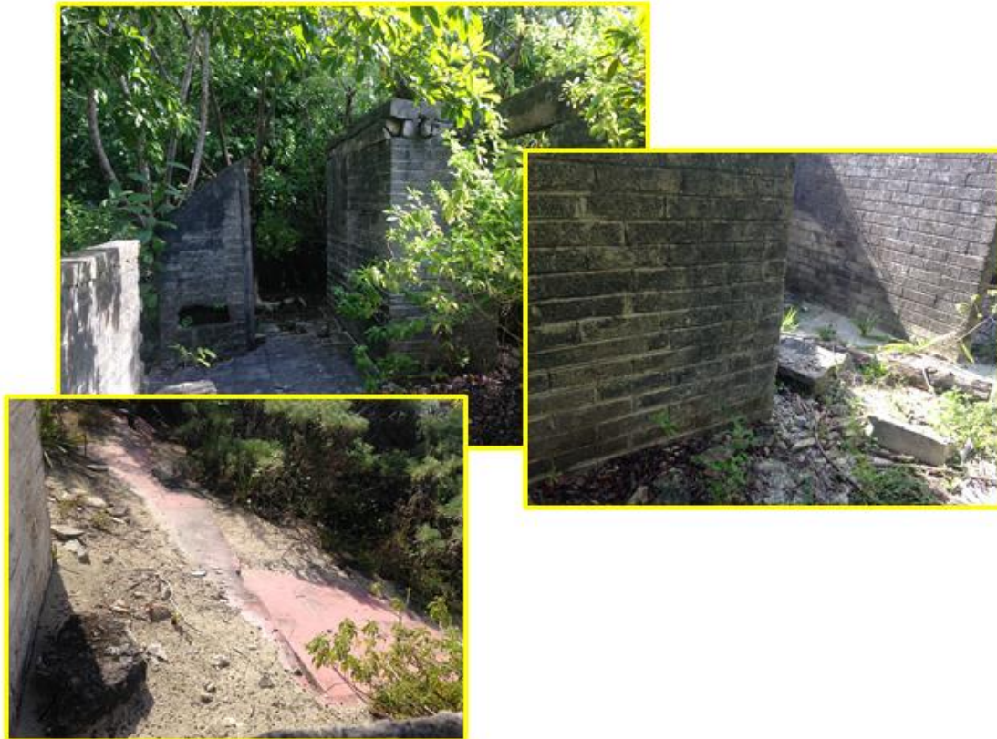
Las ruinas de obra civil
