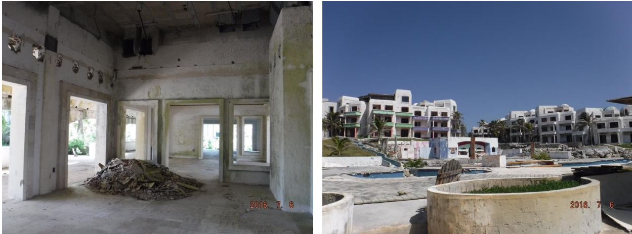
Figura 4. 15. Imágenes de la infraestructura hotelera abandonada y en ruinas que se encuentra en el lote donde pretende desarrollarse el proyecto.
