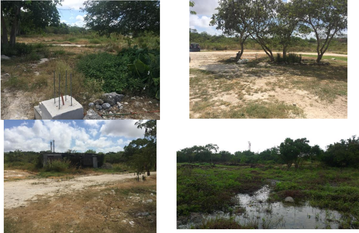
Figura No. 10 Áreas de las etapas 5, 6 y 7 sin cobertura arbórea o arbustiva como consecuencia de obras en preparación del sitio de las etapas 5, 6 y 7 cuando se ejecutaron trabajos durante la vigencia de la autorización ambiental.
