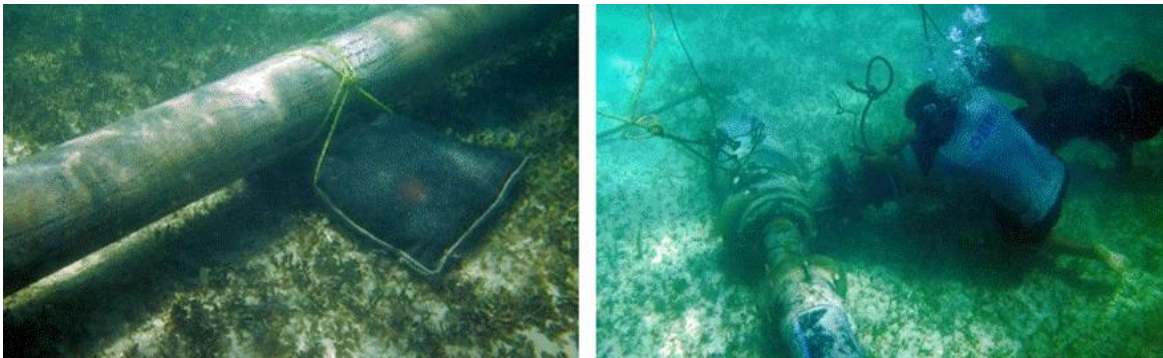
Figura II.10. Ejemplo de la instalación de la tubería de conducción para el bombeo de arena y del propio equipo de bombeo.
