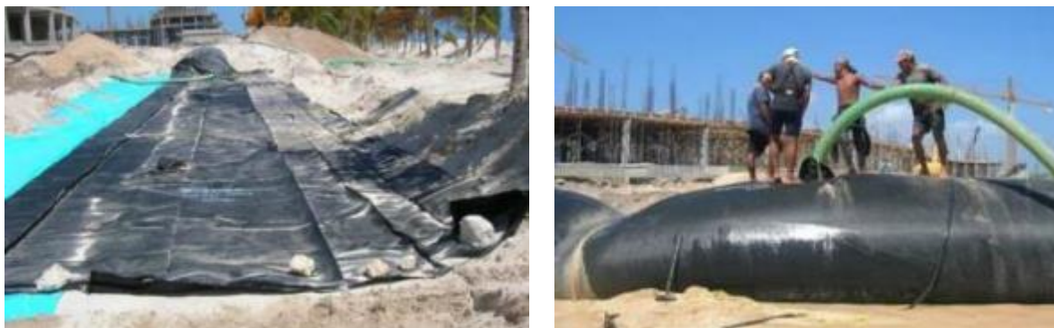
Figura II.12. Ejemplo del extendido, amarre y preparación del geocilindro que conformará la Duna Artificial y del llenado del geocilindro con una tubería flexible de 6 pulgadas.
