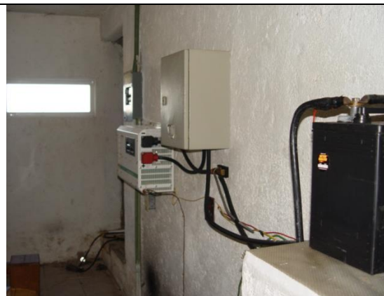
Convertidor de energía que la canaliza a las baterías.
