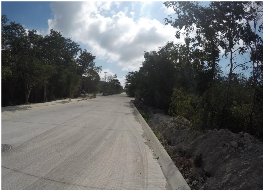
Figura VIII.1. Vista general de la vialidad que se extiende en el límite oriente del predio del proyecto.
