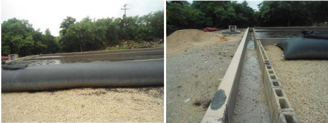
Figura 7. Planta de tratamiento. Arriba se muestran las áreas donde se realiza el proceso de aireación; en el centro se observa el tanque sedimentador y el área de cloración, y abajo el área donde se procesan los lodos.
