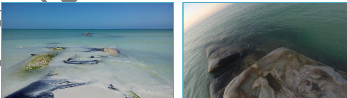
Figura VII_ 3. Estado de los espigones existentes.
