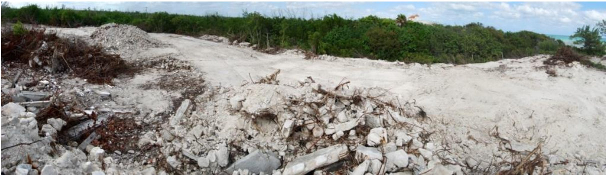
Figura 7. Escombros remanentes al interior lote de terreno marcado con el número 4-01, manzana 1, supermanzana 31, del predio denominado "Petempich" ubicado en la localidad de Puerto Morelos, resultado de la demolición efectuada conforme lo solicitado en el oficio 04/SGA/105/2004.
