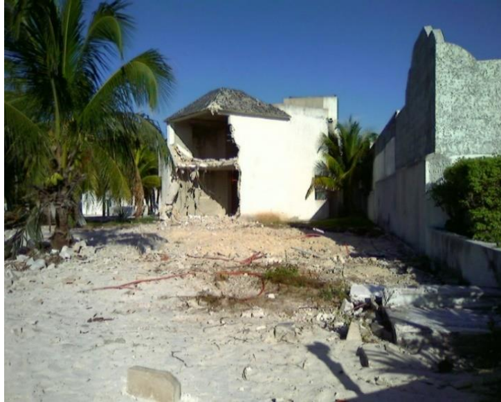
Figura 6. Aspecto de una de las obras demolidas, dentro del lote de terreno marcado con el número 4-01, manzana 1, supermanzana 31, del predio denominado "Petempich" ubicado en la localidad de Puerto Morelos, durante el inicio de las actividades autorizadas en el oficio 04/SGA/105/2004.
