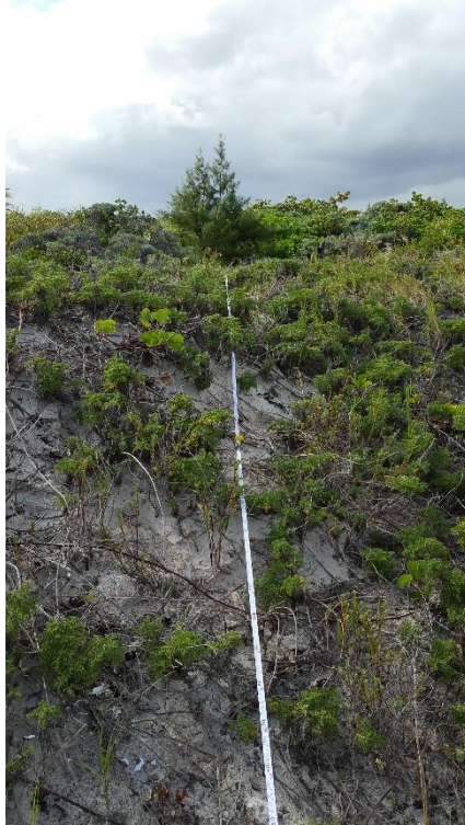
Figura 83. Acumulación de escombros y restos de la construcción cubiertos por vegetación rastrera.
