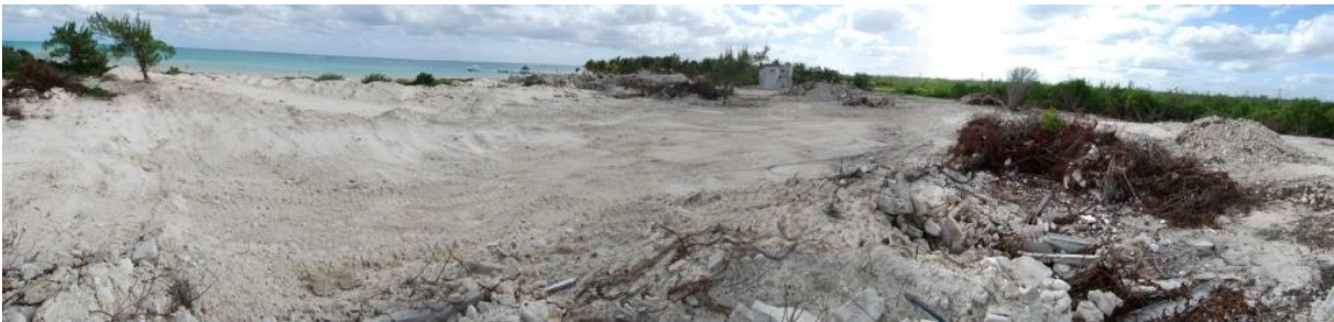
Figura 9. Aspecto de la playa en la zona centro del lote de terreno marcado con el número 4-01, manzana 1, supermanzana 31, del predio denominado "Petempich" ubicado en la localidad de Puerto Morelos, resultado de la demolición efectuada conforme lo solicitado en el oficio 04/SGA/105/2004.
