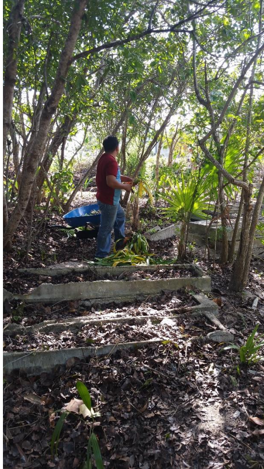
Figura 65. Crecimiento de vegetación secundaria de tipo matorral sobre restos de escombros y obra negra.
