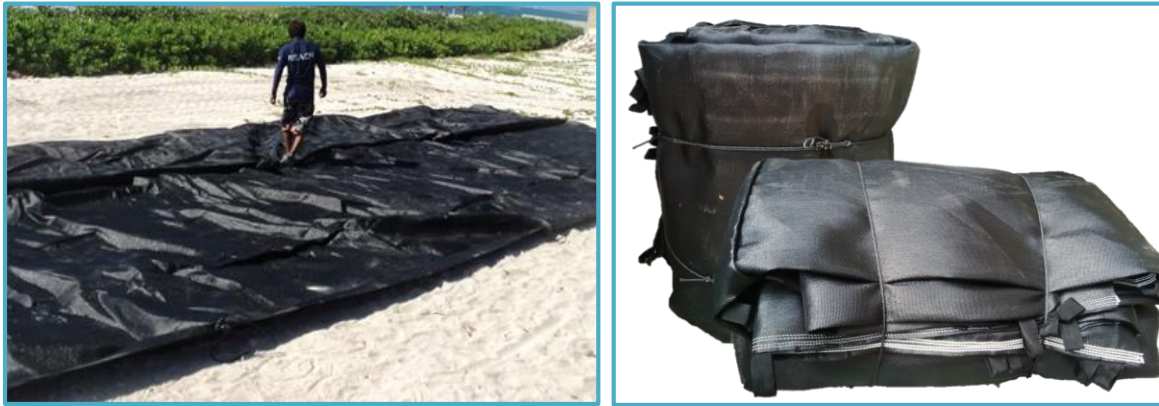
Figura II_ 17. Tubos de geotextil para el desplante de la estructura ciega del muelle.
