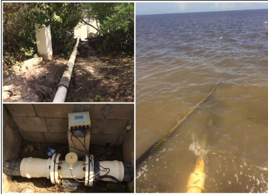
Figura IV.2.1.7.2-1. Infraestructura para la distribución de agua potable en la Isla Holbox, desde Chiquilá
