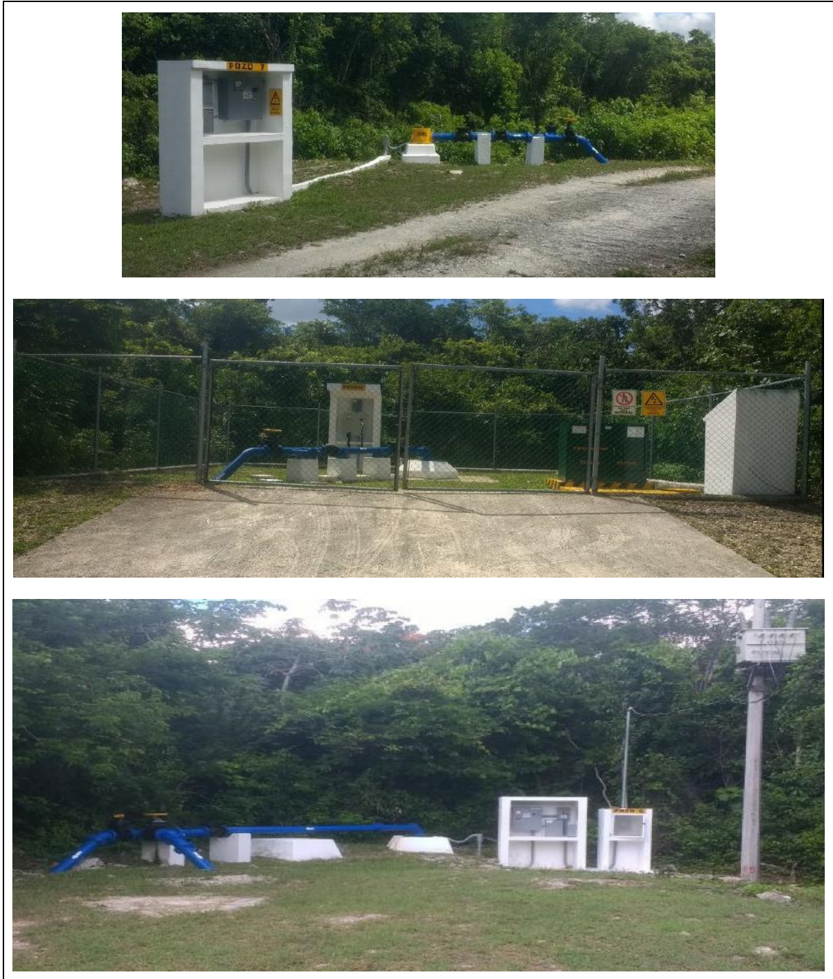
Imágenes de algunos pozos de captación (ver Anexo fotográfico Solidaridad).
