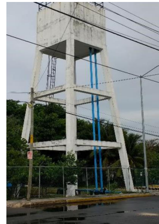
Tanque Elevado "Cárcamo 4"
