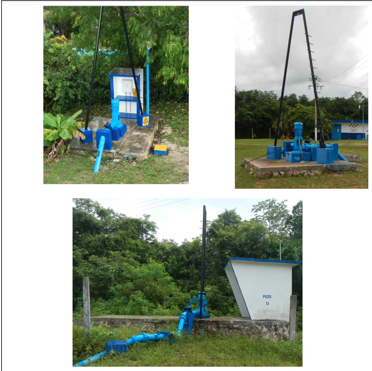
Figura II. 6. Pozos de captación.
