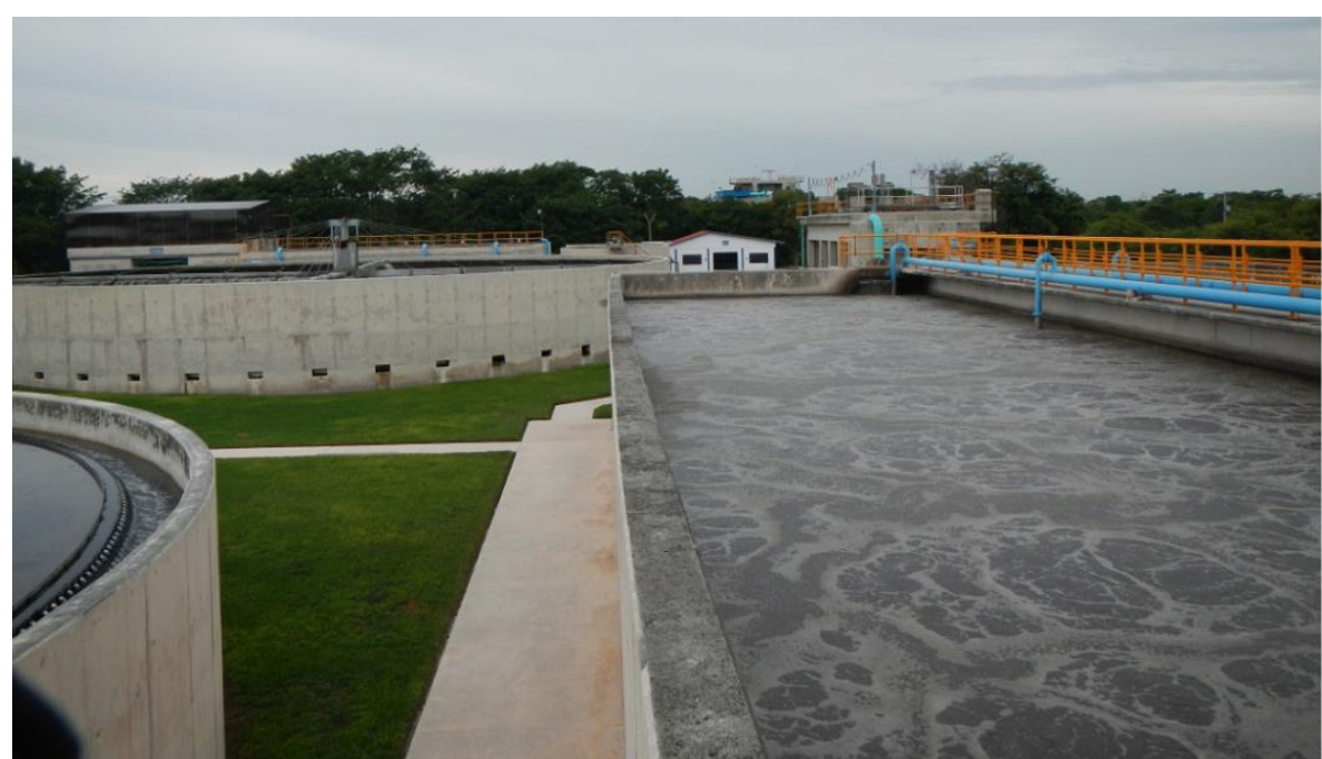
Planta de tratamiento de aguas residuales, "Norte".
