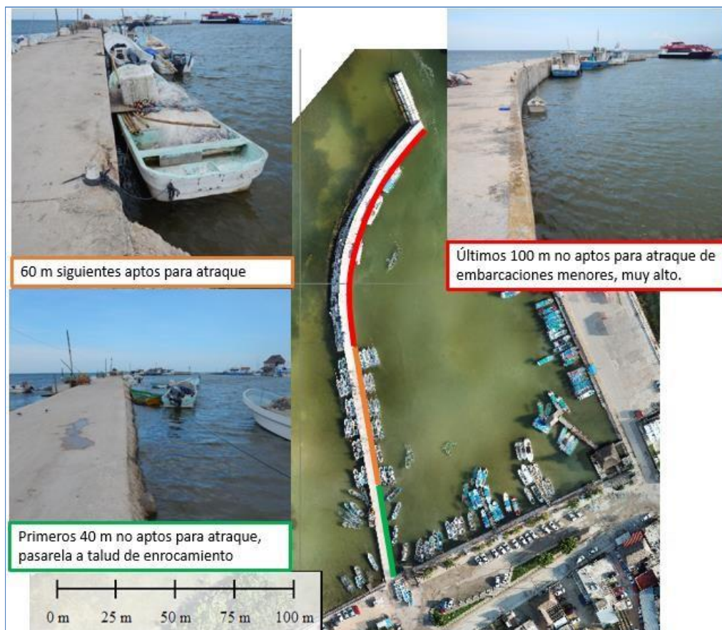
Figura VIII 11. Vista aérea del muelle de pescadores y fotos de las diferentes partes del muelle respecto a la funcionalidad del mismo para el atraque de embarcaciones menores.
