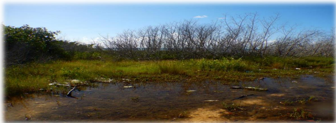
Fotografía IV. 66. Vista del acceso azolvado en la desembocadura.
