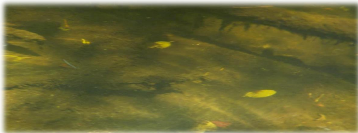
Fotografía IV. 60. Abundante presencia de sedimentos.
