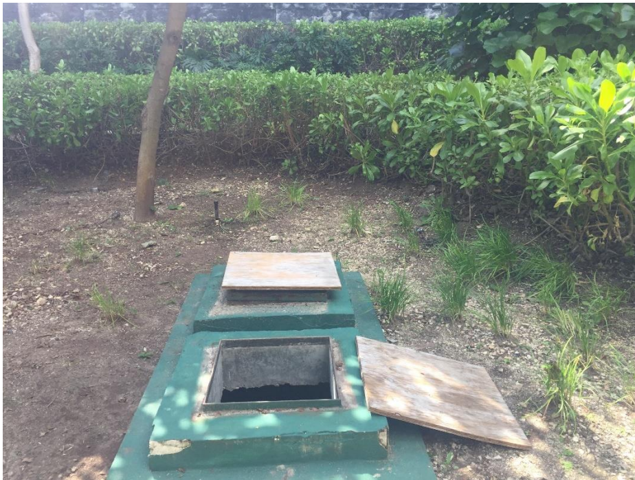
Pozo de inyección, ubicado en áreas ajardinadas
