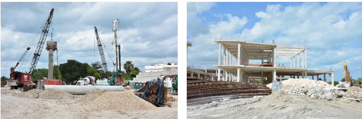
Figura 39. Condiciones actuales del sitio donde se ubicará el Hotel La Isla Cancún y que corresponden al Edificio 1 autorizado en el proyecto La Isla Cancún, actualmente en construcción.
