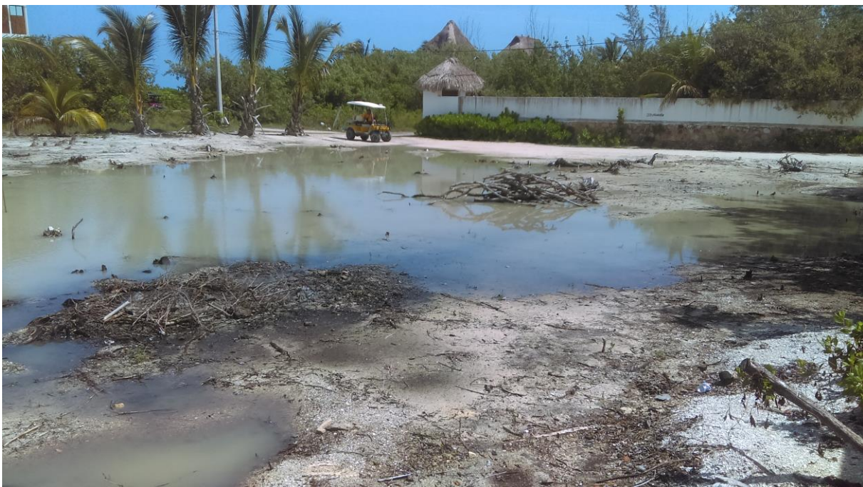
Figura II.9. Como se puede observar la vegetación fue removida de manera manual dejando los toconos y demás residuos los cuales podrán ser triturados y esparcidos en áreas verdes.
