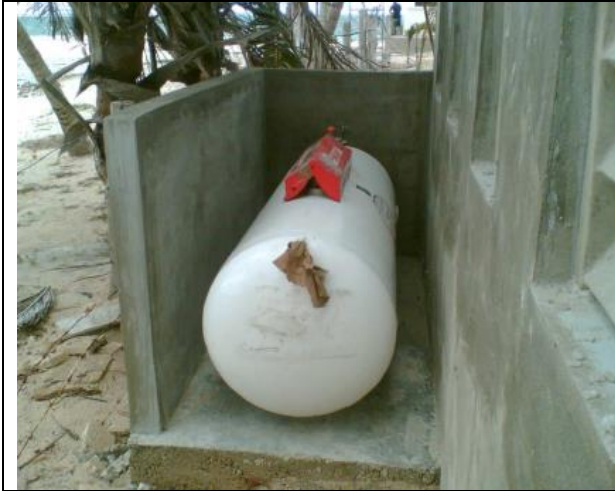
Ejemplo de tanque estacionario de Gas.
