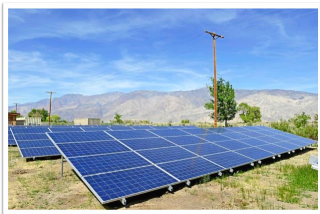
Ejemplo de paneles solares en tándem para surtido de energía eléctrica.
