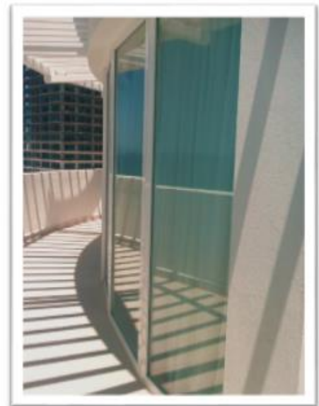
Ejemplo de cancelería de fachada en habitaciones.
