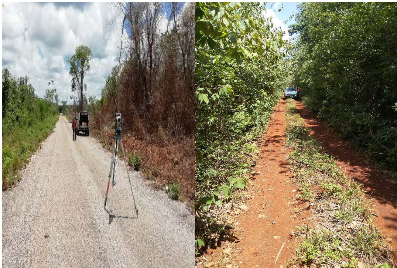
Figura 25.- Condiciones en el cual se encuentra el camino actualmente.
