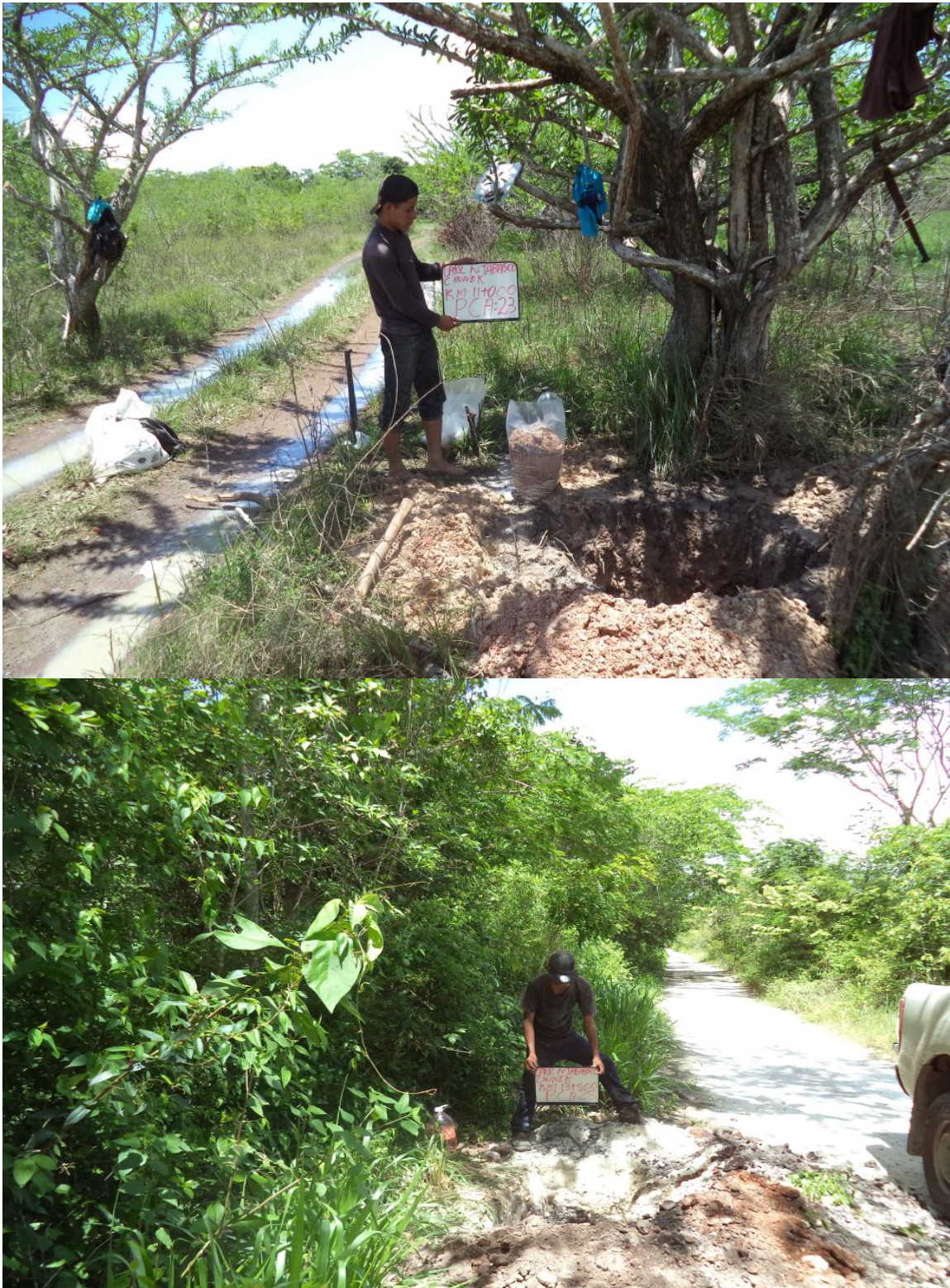
Figura 26.- Condiciones en el que se encuentra el camino actualmente.
