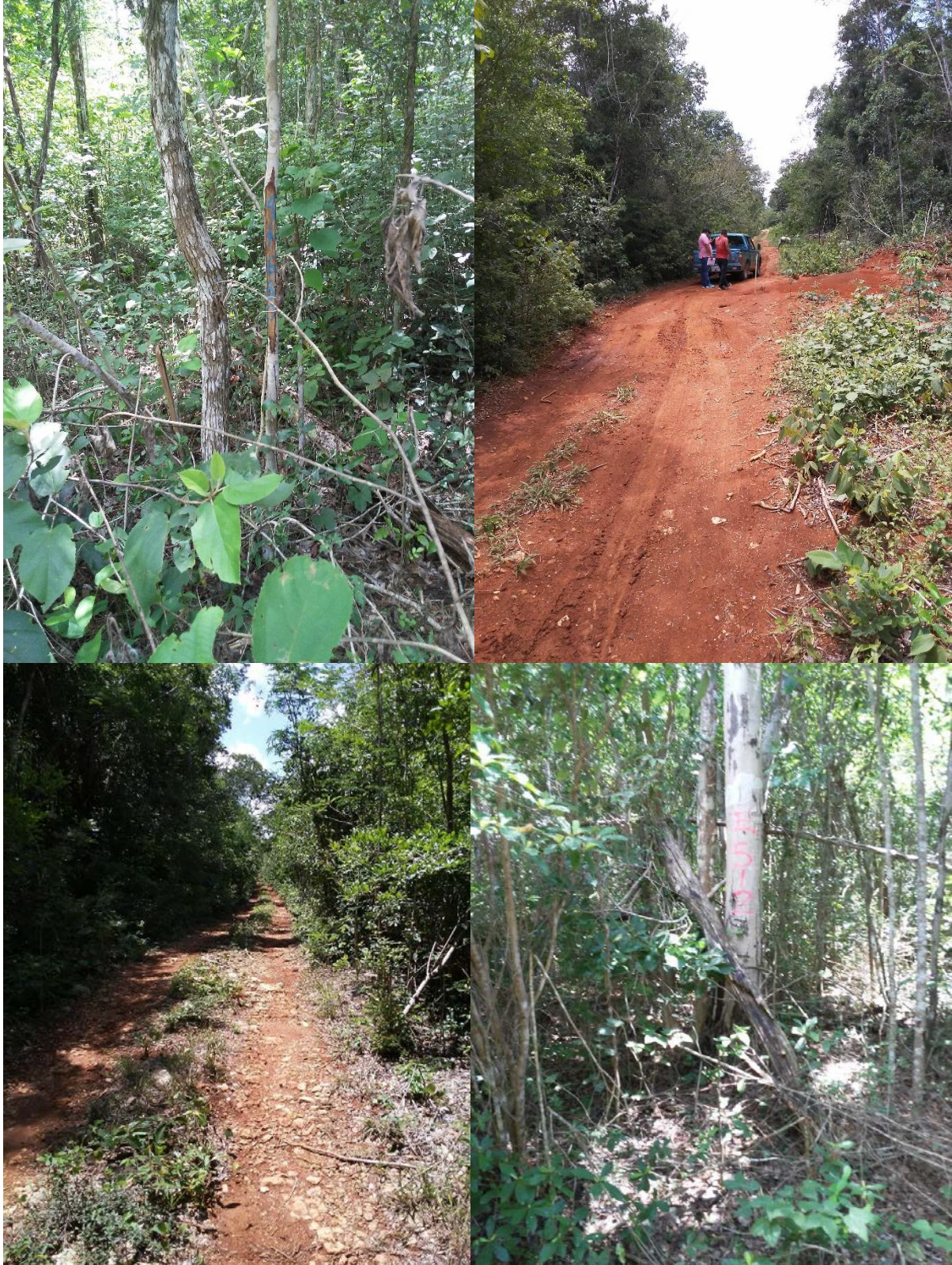
“AMPLIACIÓN Y MODERNIZACIÓN DEL CAMINO NUEVO TABASCO – CHUN EK, CON UNA META DE 16+080 KM EN LOS RESPECTIVAMENTE “MUNICIPIOS DE BACALAR Y HOLPECHEN EN LOS ESTADOS DE QUINTANA ROO Y CAMPECHE”
