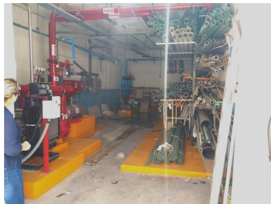
Foto 1.- Área de ubicación del sistema de potabilización
