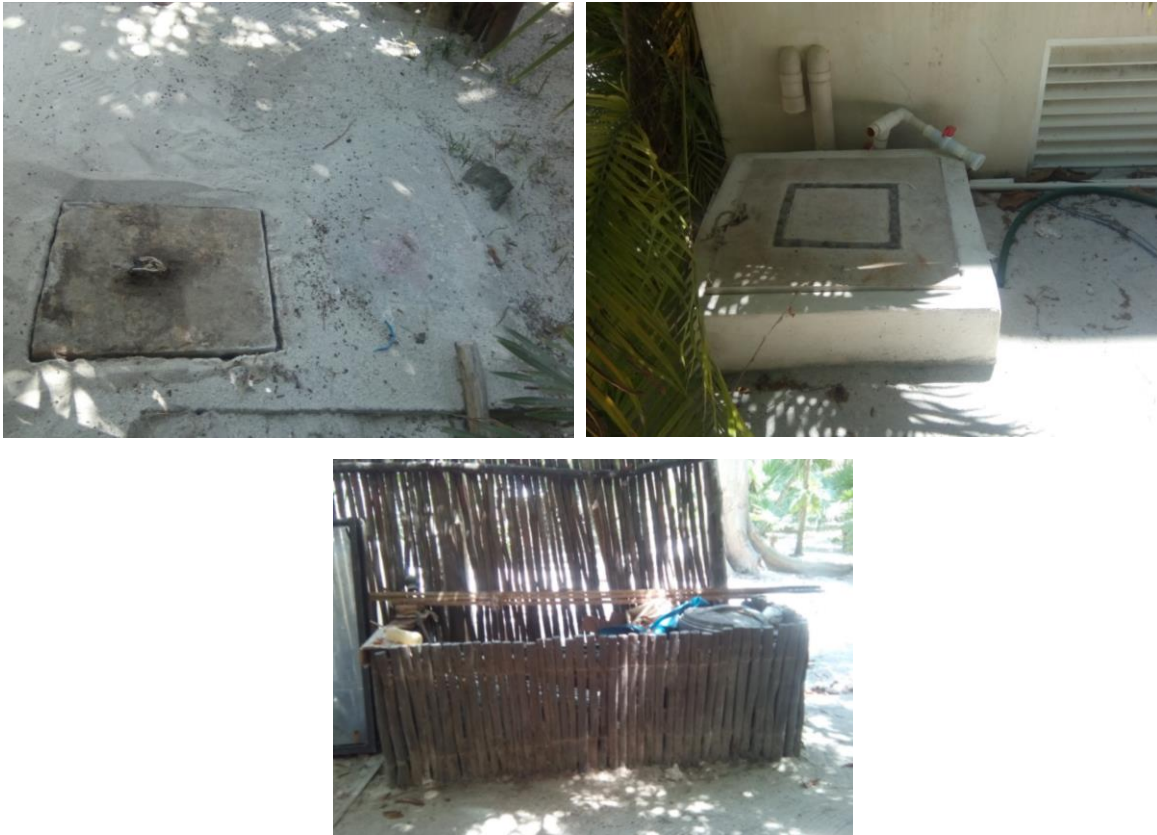
Figura 12. Registros 1 y 2, y contenedor de residuos sólidos.
