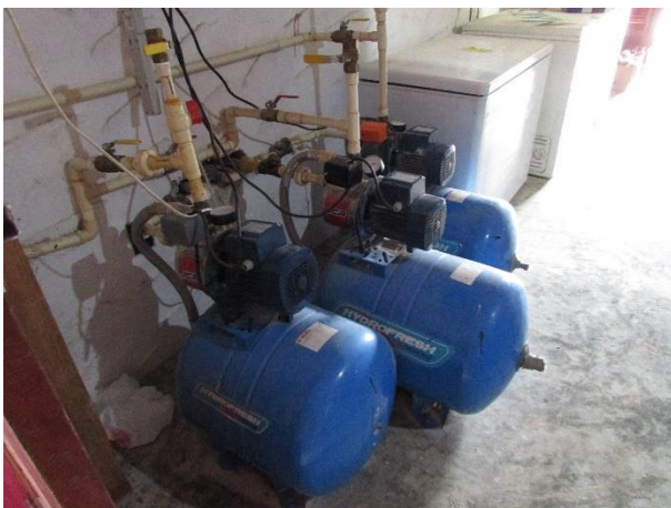
Figura 7. Se muestra los hidroneumáticos con los que cuenta el hotel.
