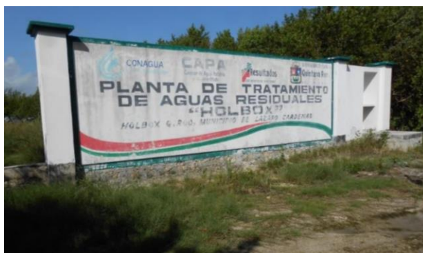
Figura 8. Se muestra la condición de la PTAR del Holbox
